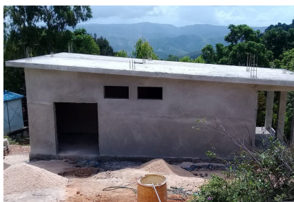
Kühlraum in Martel / Chambre froide
