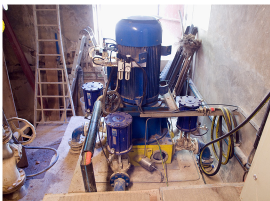
La turbine hydroélectrique
